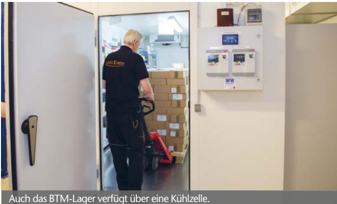
Auch das BTM-Lager verfügt über eine Kühlzelle.
